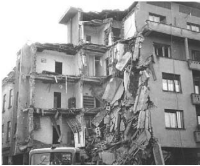
Sl. 3. Oštećenje objekta nakon potresa
